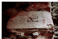
11. Radvanov – detail chvěy se mlýna chvěy v domovném základě v přístřeší větrného mlýna. Snímek autor, červen 2010.
